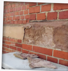
Schäden am Sandstein
