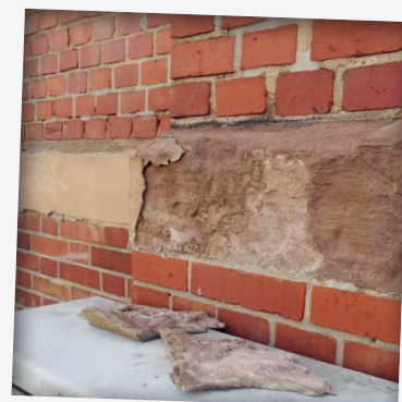
Schäden am Sandstein
